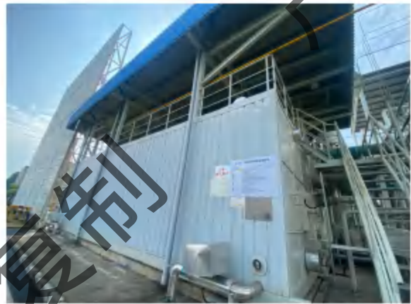
原有项目 2 号锅炉
