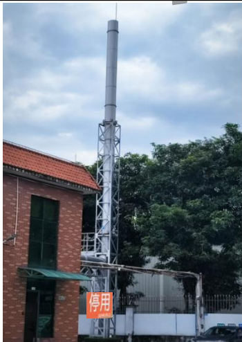
污水处理站废气排气筒
