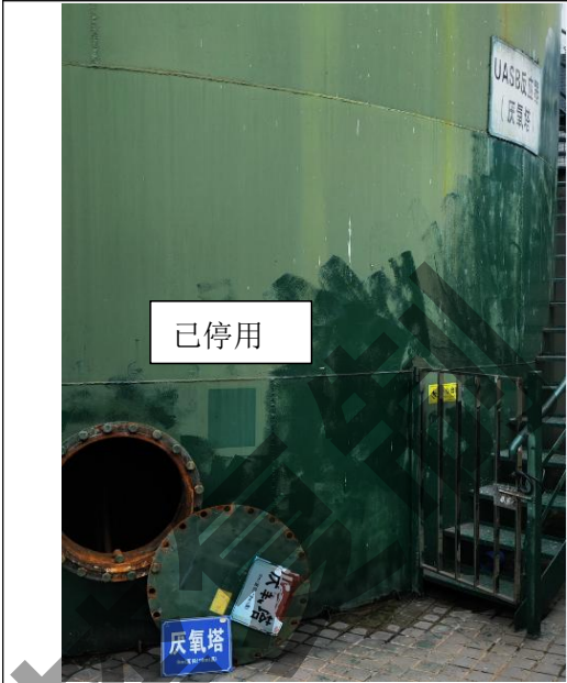
UASB 反应器 (厌氧塔) 已停用
