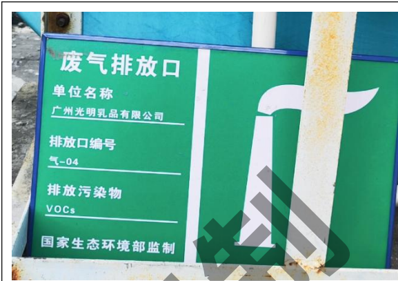
有机废气排放口
