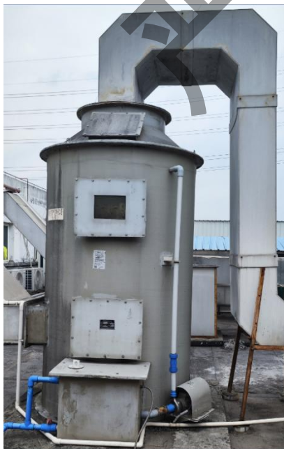
无机废气碱液喷淋塔
