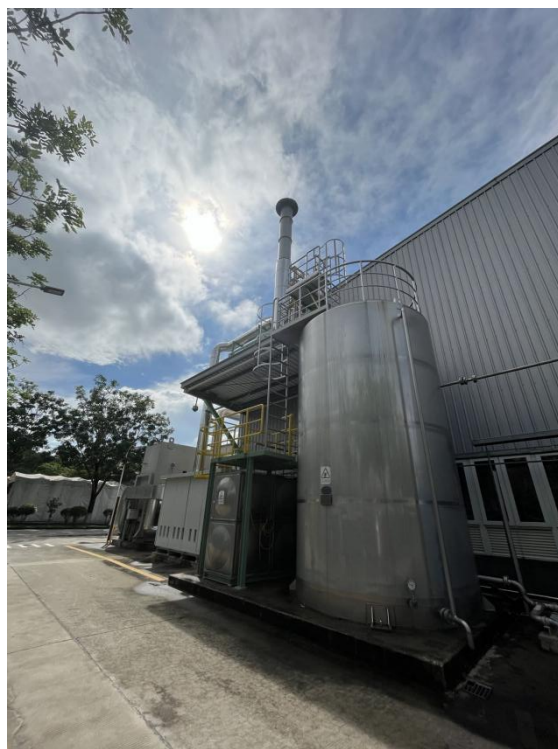
静电除颗粒系统+活性炭吸附装置、蓄热式热氧化装置（气-03）
